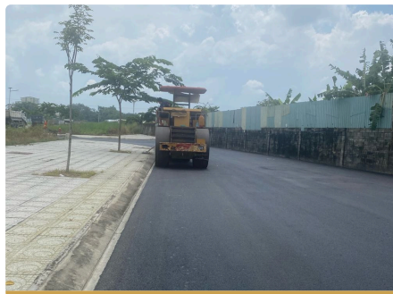
Lu lên mặt đường bê tông nhựa
